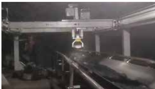
• 矿用皮带异物分拣机器人 (框架式 - 高速) 现场应用
