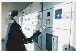
◎ 电力场景巡检
