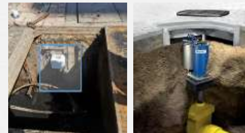
燃气地下管网和阀井监测
