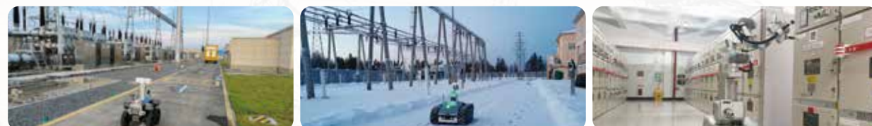
▲ 福建某500kV变电站
