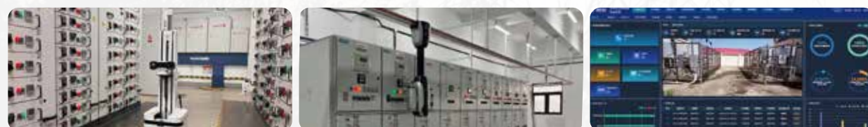
▲ 亚运供电单位某配电房
