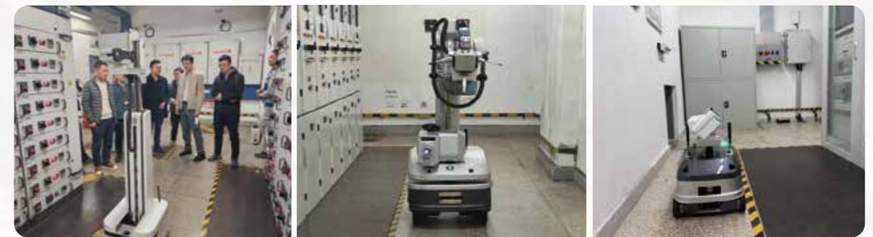
▲ 供电巡检机器人系列运用案例
