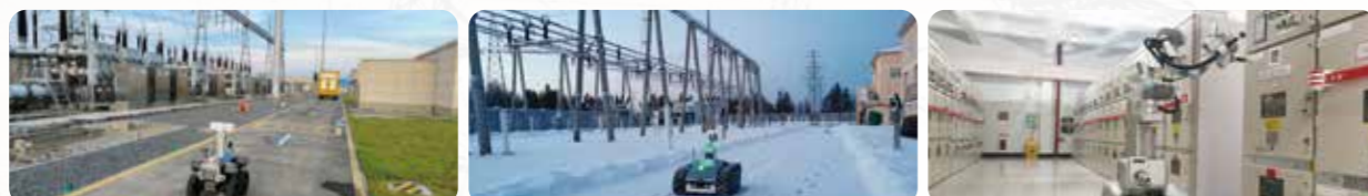
▲ 福建某500kV变电站
