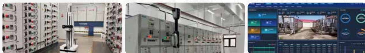
▲ 亚运供电单位某配电房
