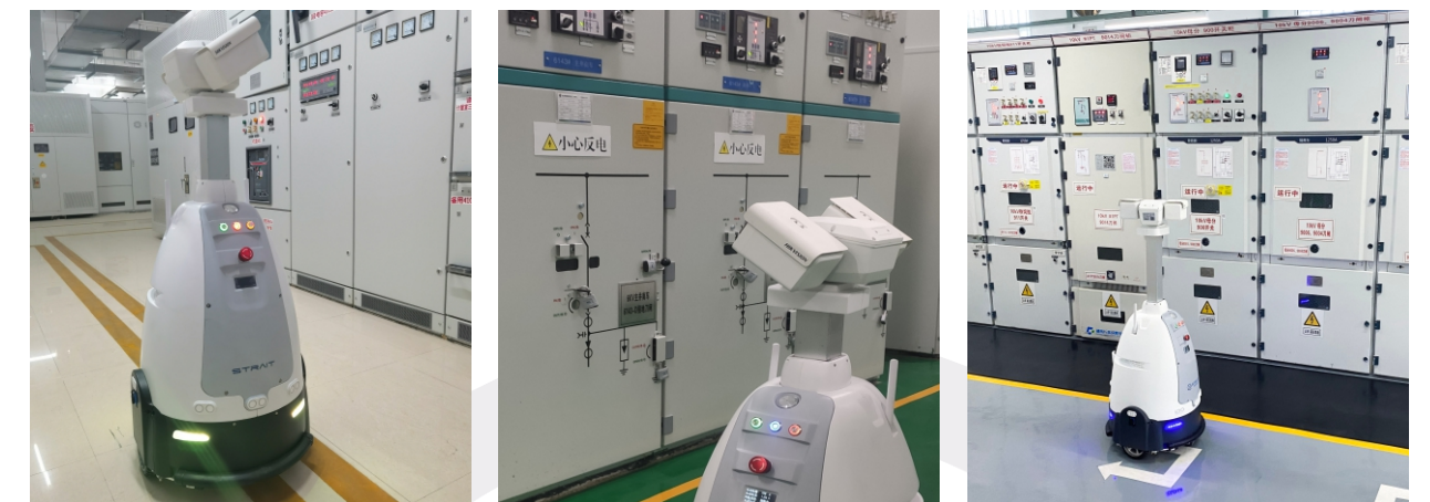
国网某电力公司配电房智能巡检
