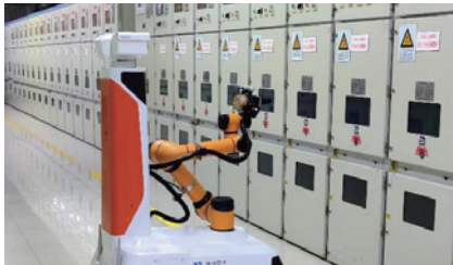
高压配电柜操作
